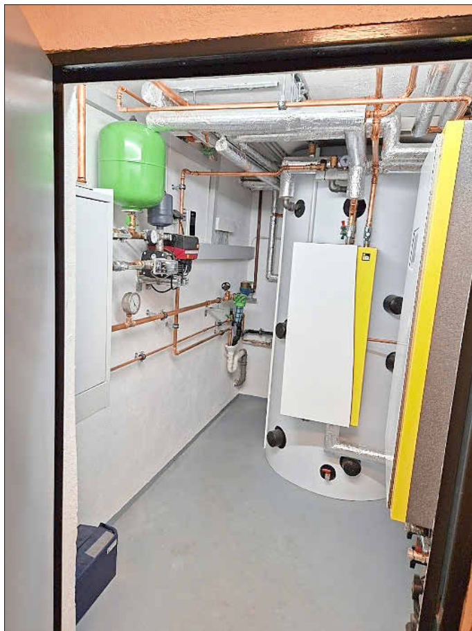
Die neue Heizungsanlage mit einer Wärmepumpe und einer intelligenten Steuerung zur optimalen Stromnutzung.
